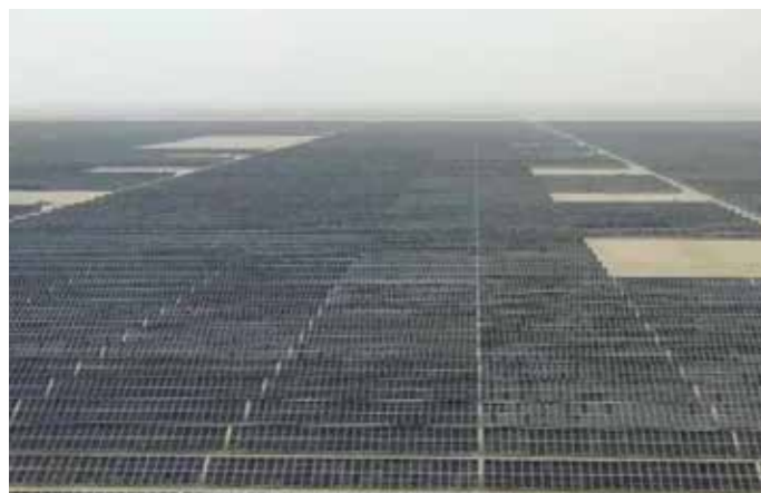
300MW 新疆若羌地面光伏项目
