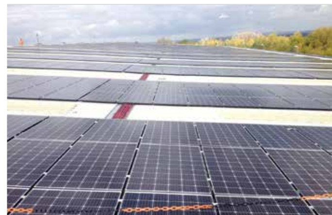
3.8MW 英国利物浦分布式光伏项目
