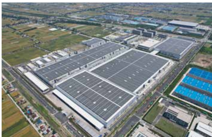
40.8MW 江苏东台分布式光伏项目
