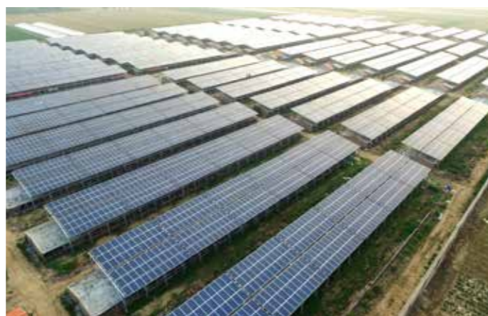
60MW 山东潍坊畜光互补光伏项目
