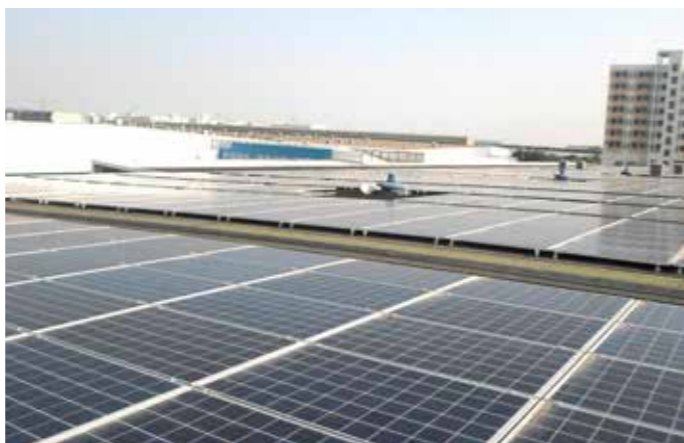
35MW 广东广州屋顶光伏项目
