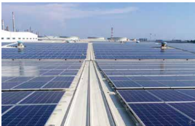
24MW 海南儋州分布式光伏项目
