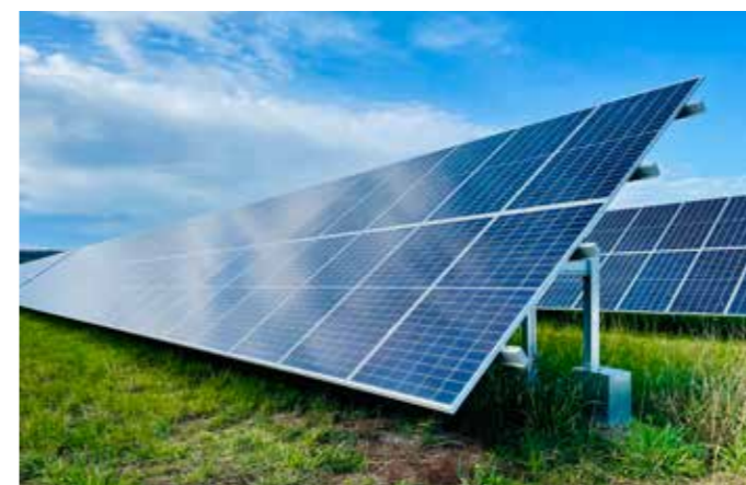
12.3MW 澳洲墨尔本机场地面光伏项目
