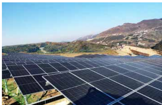
120MW 湖南冷水江山地光伏项目
